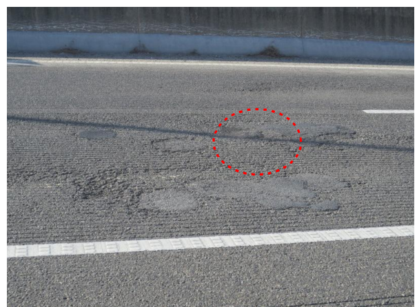
교면포장 포트홀 S1
