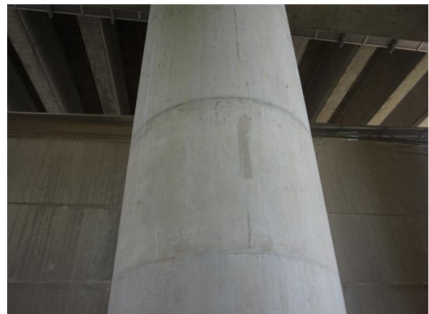
교각 망상균열 P1
