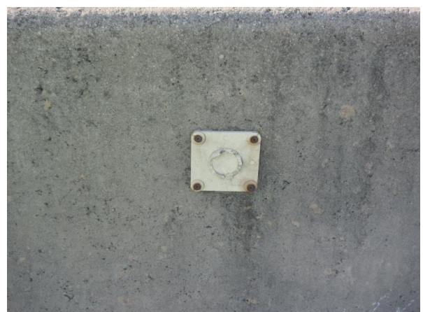
텔레네이트 파손 S3
