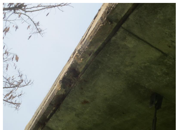
바닥판 파손 S3
