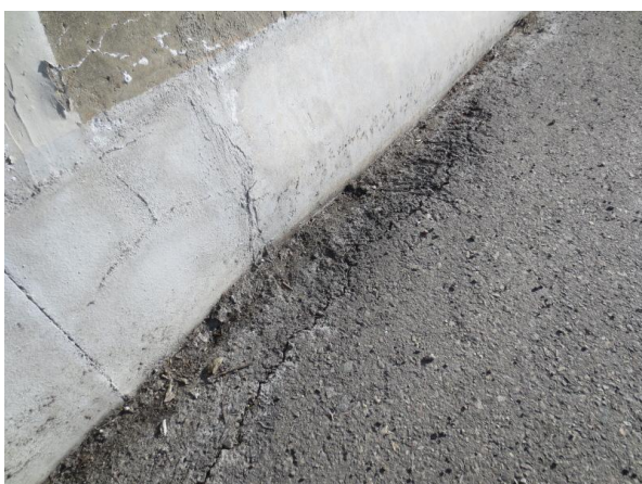
교면포장 균열 S1
