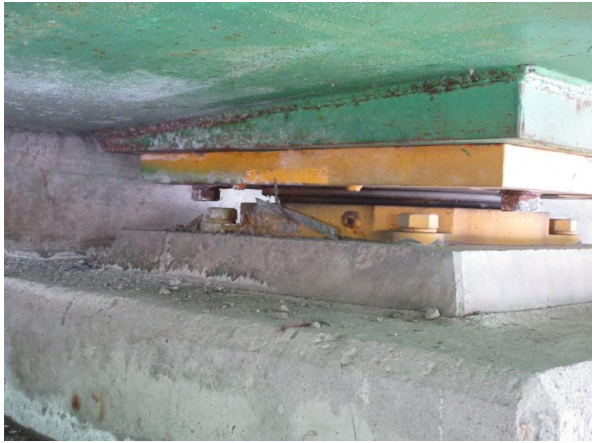
받침장치 이동량 게이지 탈락 A2-SH2
