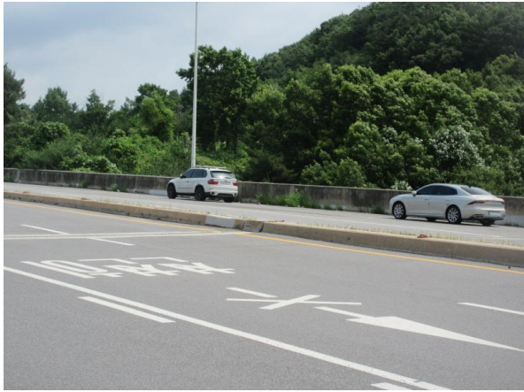
중앙분리대 차선 규제봉 탈락 S2~3
