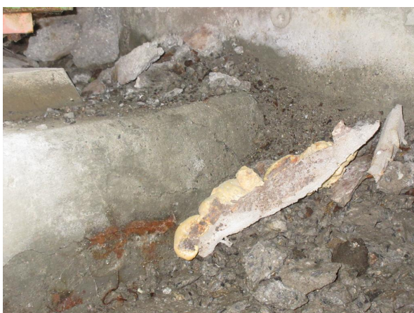
반침콘크리트 파손 A1-SH1
