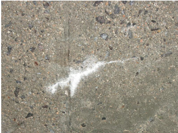
바닥판 균열부 백태 S2
