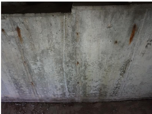
교대 균열(0.3mm이상) A2
