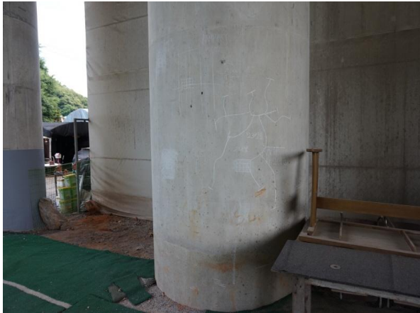
교각 망상균열 P1
