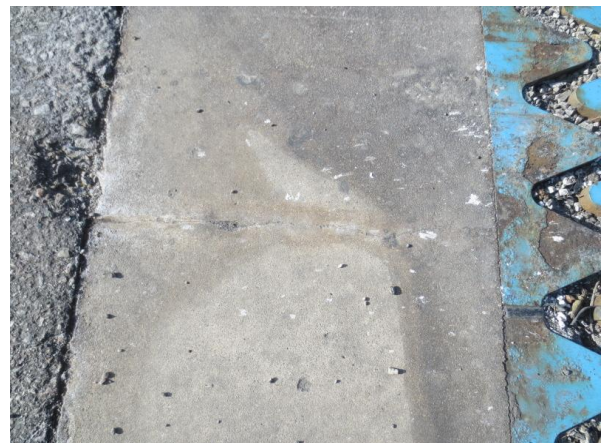
후타재 균열(0.3mm미만) Exp.Joint-A1
