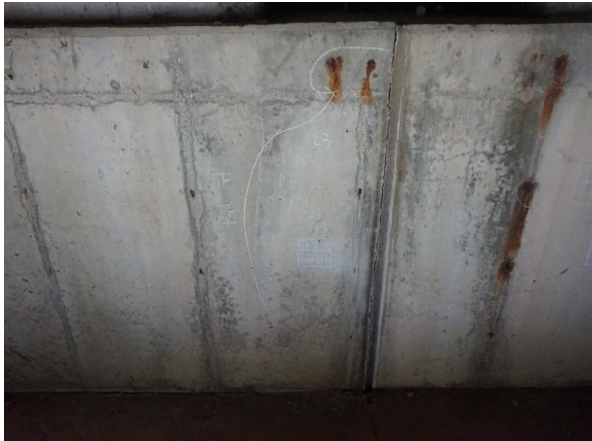
교대 균열(0.3mm미만) A2
